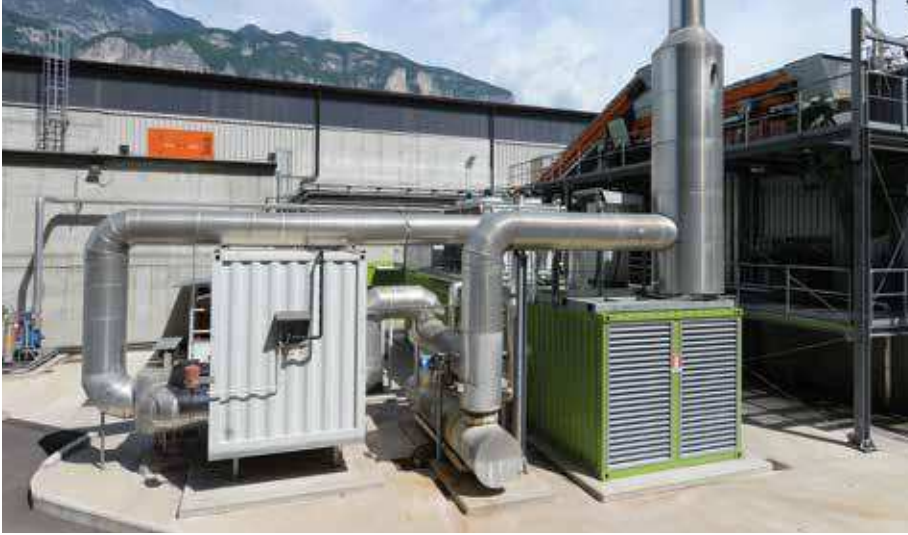
Foto 1: sezione di cogenerazione per la produzione di energia elettrica e termica dalla digestione anaerobica di rifiuti organici
