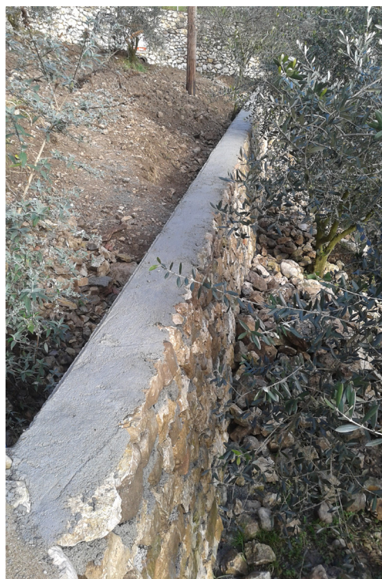
Foto 3 Muro finto secco
